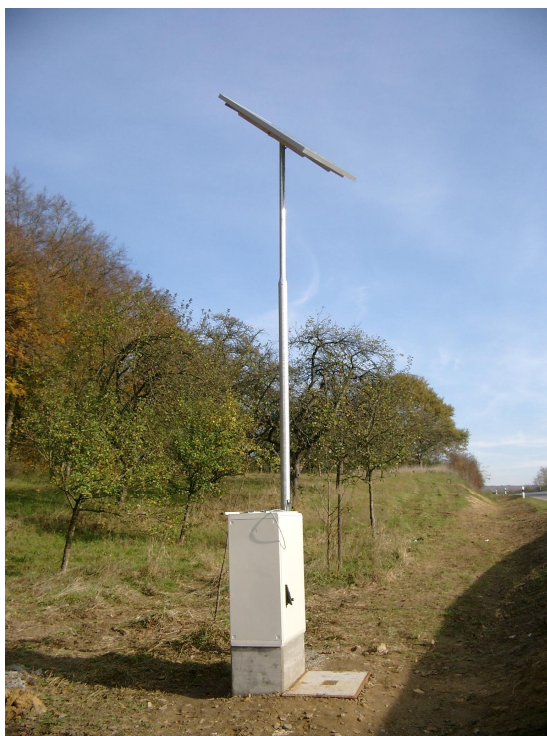
Steuerung mit Hochleistungssolarzelle an der B292 bei Aglasterhausen nahe Heidelberg
