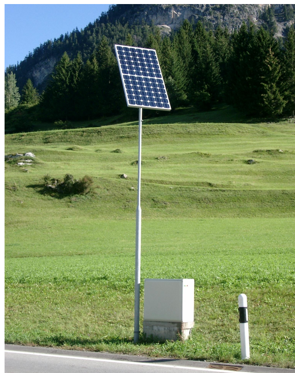
Steuerung mit Hochleistungssolarzelle An der Julierstrasse nach St. Moritz Schweiz
